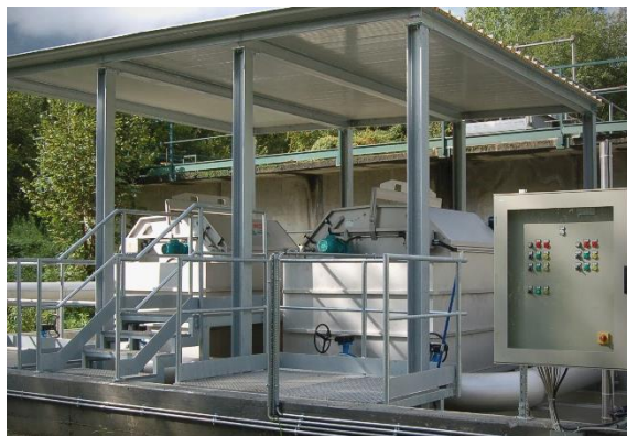
Filtres à disque avec carter inox. Montage en parallèle
