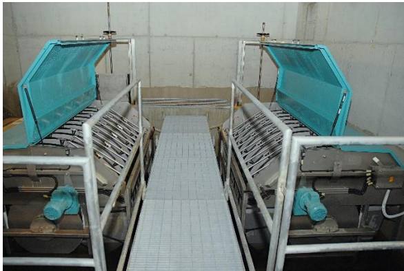
Filtres à disque posés en chenal. Montage en parallèle
