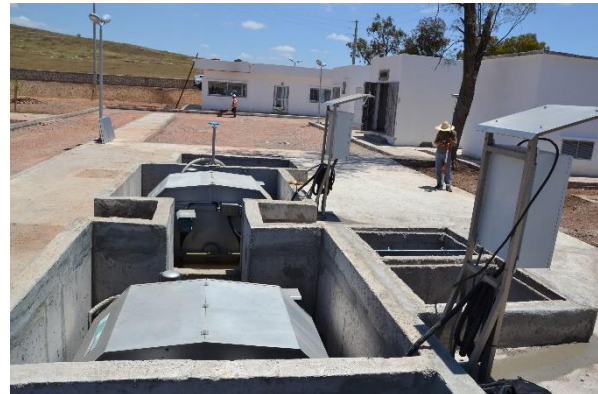
Filtres à disque posés en chenal. Montage en série
