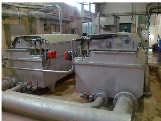
Filtres à tambour avec carter inox. Montage en parallèle
