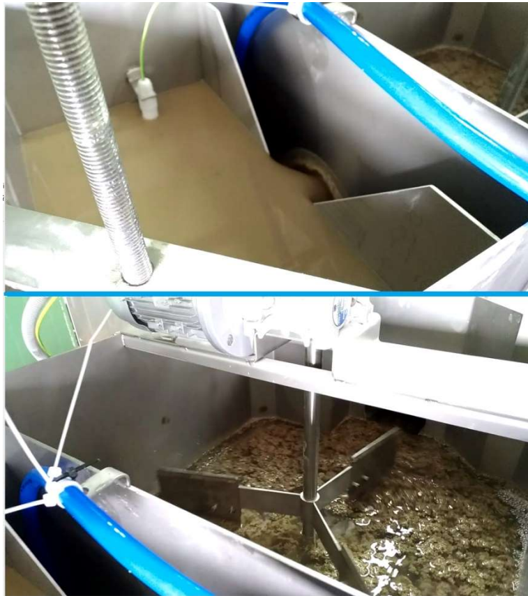
Fig. 12 : Effet polymère : boues brutes dans la cuve d'alimentation sans flocculant (en haut) et flocs de taille optimale dans la cuve de floculation (en bas)
